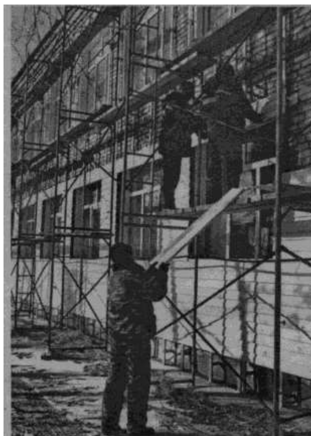
Рис 6. Рабочие ООО «Контакт» на реконструкции детского сада «Сказка» в с.Ключи, декабрь 2010 г. Фото из архива редакции газеты «Степной маяк».
